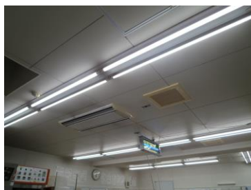
アルドールに設置されたLED照明
